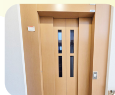
エレベーター
